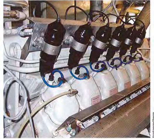
Im Container-Modul des Blockheizkraftwerks von Yados: Zu sehen ist die linke Motorreihe des V12-Motors mit Abgastrakt und Turbolader.
